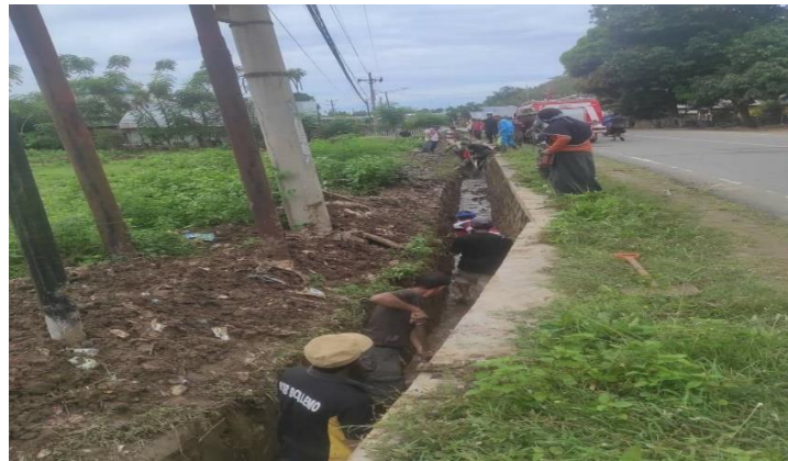
Gambar 2. Pembersihan Drainase sebagai salah satu penyebab terjadinya banjir di Desa Botumoito.
